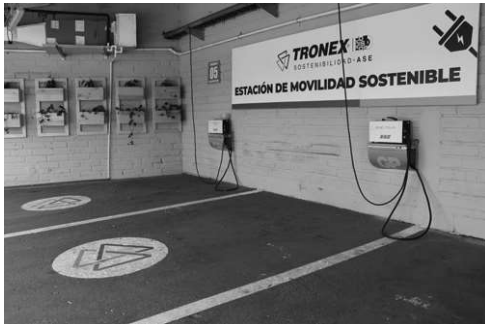
Parqueadero para movilidad sostenible con estación de carga
